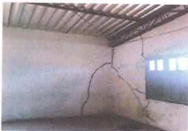
4- Estrutura sem condição de uso
