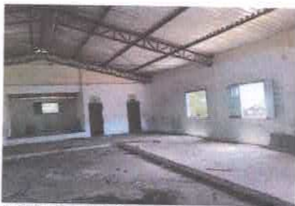
1- Prédio sem condições de uso
