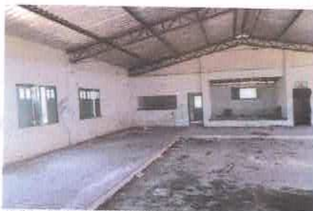
2- Piso quebrado e fissurado
